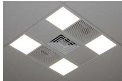
オフィス階 LED 照明
