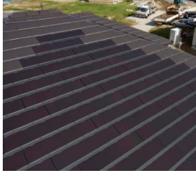
【太陽光パネル】
