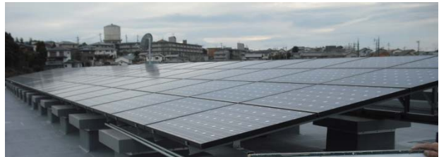
【屋上に設置した太陽光パネル】
